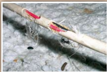
Roeduras en los cables con excremento.*
